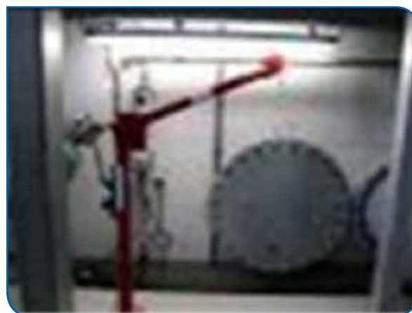
HIJSVOORZIENING OM ZWAAR LUIK MANGAT TE KUNNEN HIJSEN (VOORKOMEN VAN FYSIEKE BELASTING)
